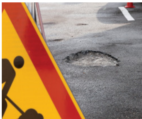
Buca stradale pronta per essere riparata
