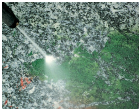
Lavaggio con acqua in pressione di serizzo trattato con WallGard Graffiti Barrier
