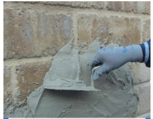
Applicazione a cazzuola di MapeWall Intonaco Base su muratura in blocchi di tufo
