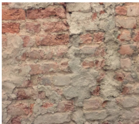
Supporto disomogeneo da risanare
