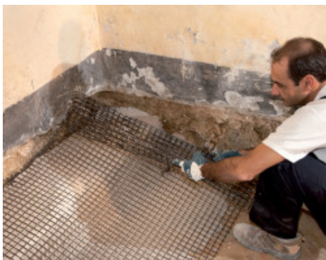
Posizionamento della rete di rinforzo in fibra di vetro alcali-resistente Mapegrid G 220
