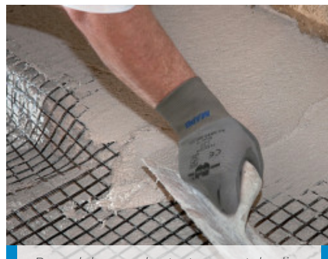
Posa del secondo strato a spatola di Planitop HDM Restauro all'estradosso di una volta in modo da coprire in maniera omogenea la rete
