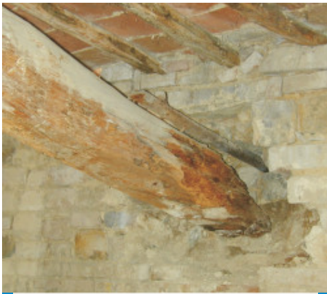
Trave degradata sull'appoggio
