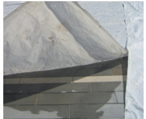
Esempio di protezione della pavimentazione
