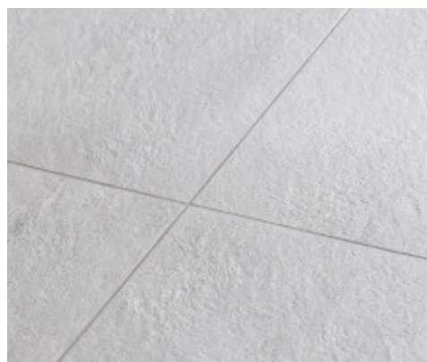
Pavimentazione stuccata con Keracolor GG
